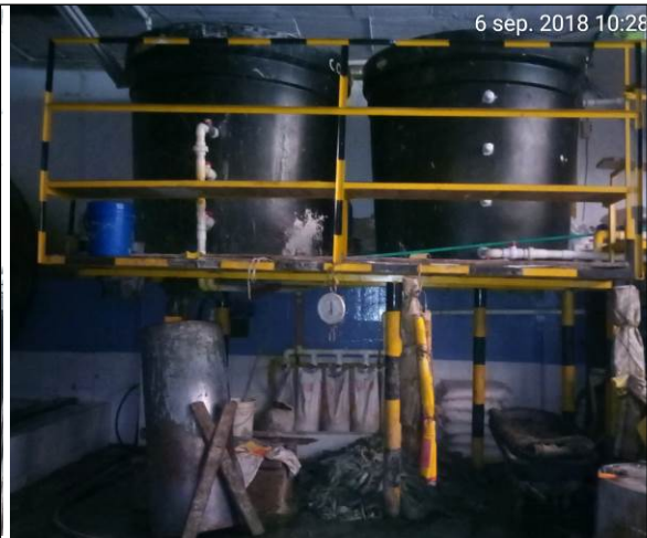
Foto No. 8 Vista general de la PTAR.
